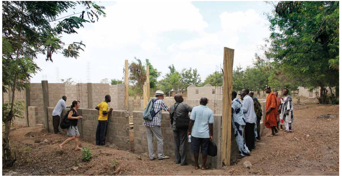
Die AGERTO Niederlassung in Akpakpakpé in 2014 – Die Vertreter von Togo-Hilfe e.V. blicken in die Baustelle für das neue Ausbildungszentrum. Heute besteht das Zentrum aus mehreren Ausbildungsgebäuden, einer Küche, einem Lager, Schlafstätten für die Auszubildenden und einer Toilettenanlage. Foto: Klaus Schmid
